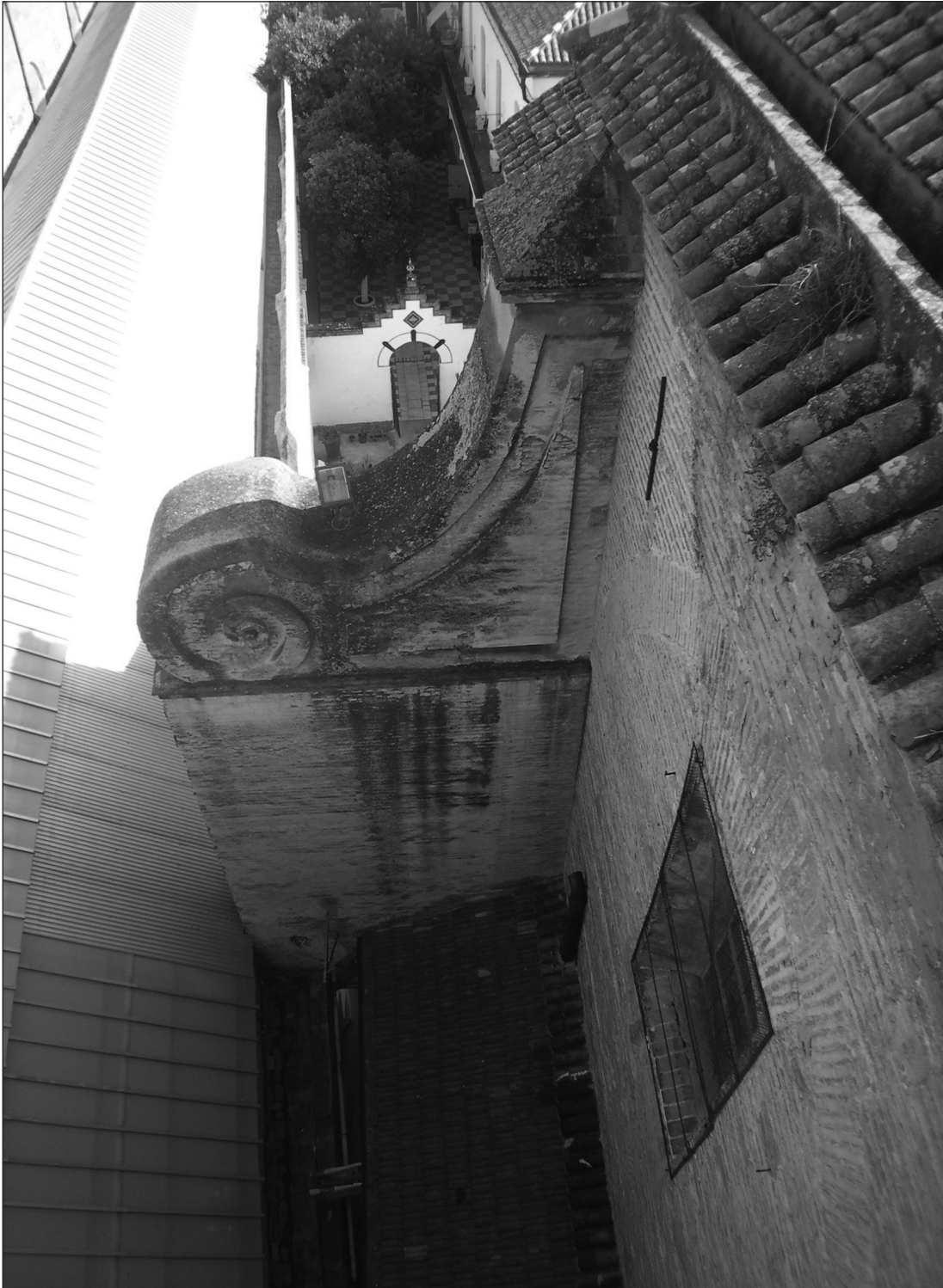
8. Cartela de remate de uno de los contrafuertes exteriores, elementos realizados por Leonardo de Figueroa en septiembre de 1679. Iglesia de la Caridad. Sevilla.
