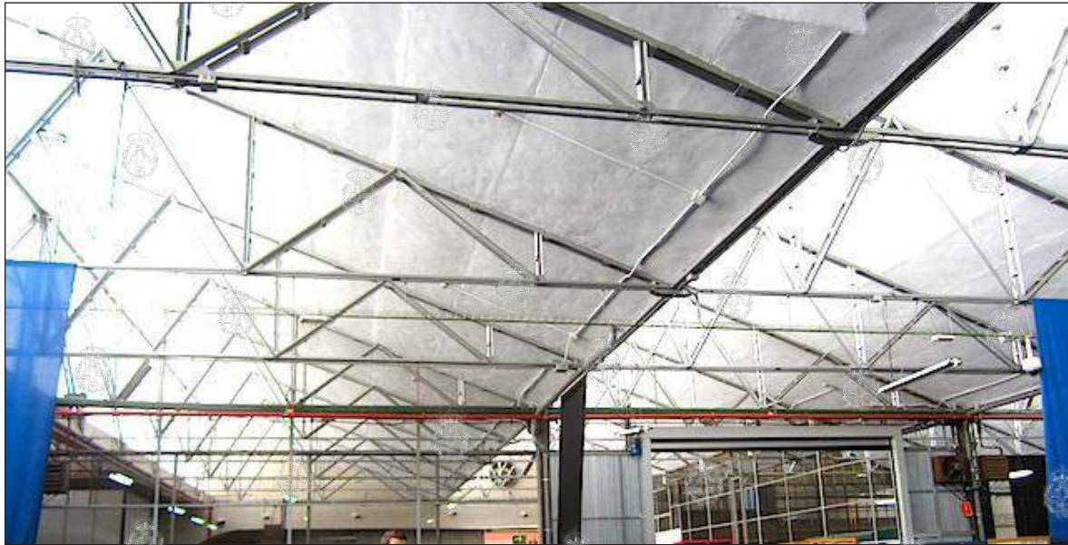
Detalle de las cerchas metálicas de la cubierta del Taller. Imagen facilitada por el PME.
